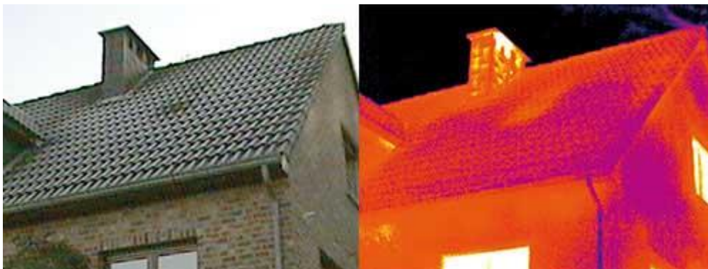
Dankzij de infraroodinspectie kan de ontbrekende isolatie op het dak ontdekt worden.
