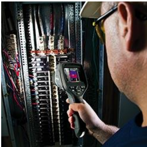
Temperatuurregeling van elektrische componenten met een warmtebeeld camera Flir Ebx-serie
