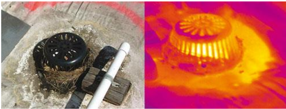
De infrarood afbeelding toont een waterlekkage in de verbinding op het dak drainage.
