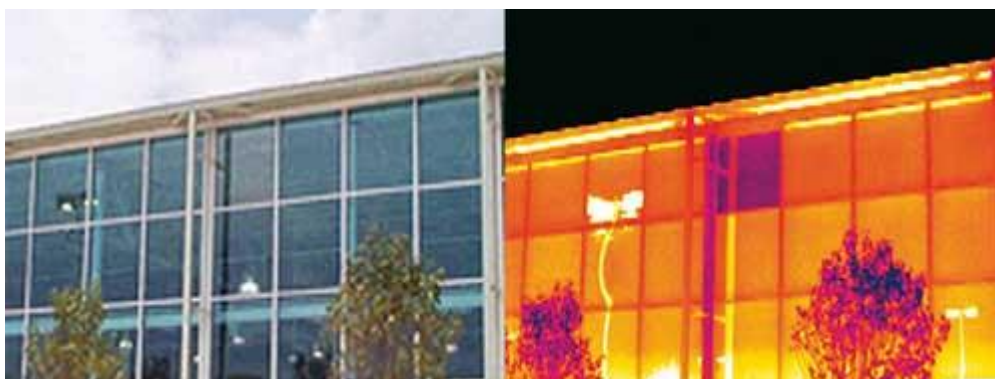
De infrarood inspectie ontdekt een verkeerd gebouwd glaselement. De coating is aangebracht aan de binnenzijde in plaats van de buitenkant van het raam.
