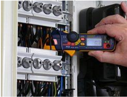
Mini multimeter tang PCE-DC2 tijdens het gebruik bij een schakelkast
